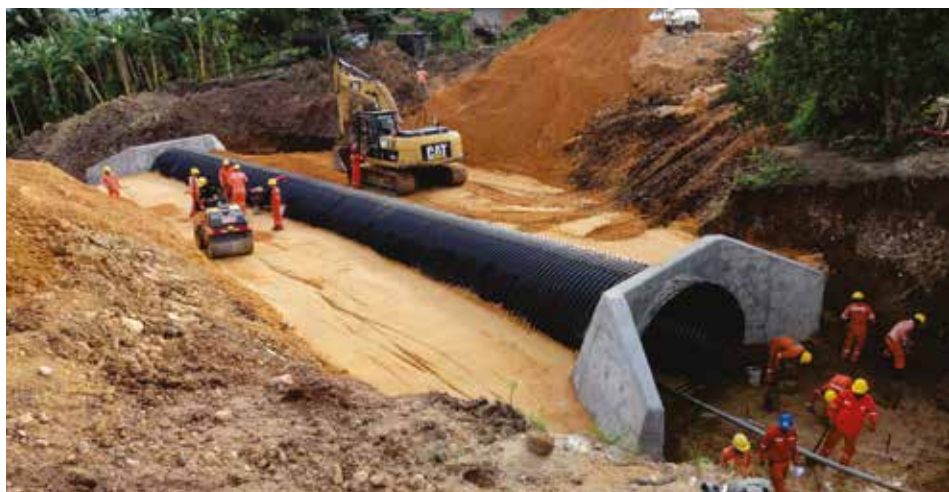
Multiplate MP 152 Bóveda - IIRSA Norte - San Martín
