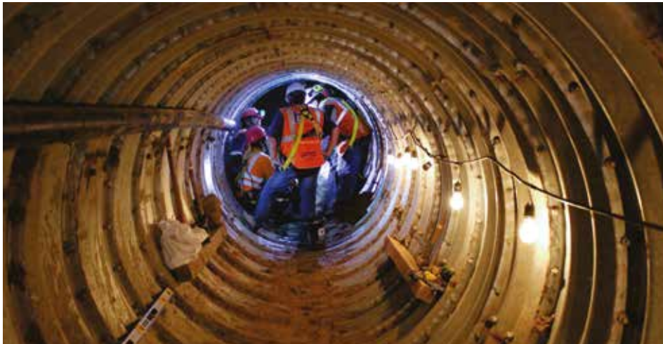
Tunnel Liner - I Proyecto Ampliación y Mejoramiento de los Sistemas de Agua Potable y Alcantarillado del Macroproyecto Pachacutec Ventanilla- etapa 1 - Consorcio Sade-Cosapi
